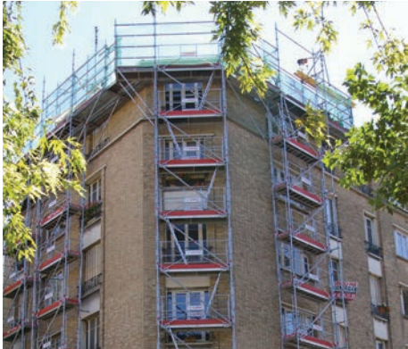
Chantier de couverture signé Ets Gérard, situé au 149 bld Jean Jaurès, à Clichy.
